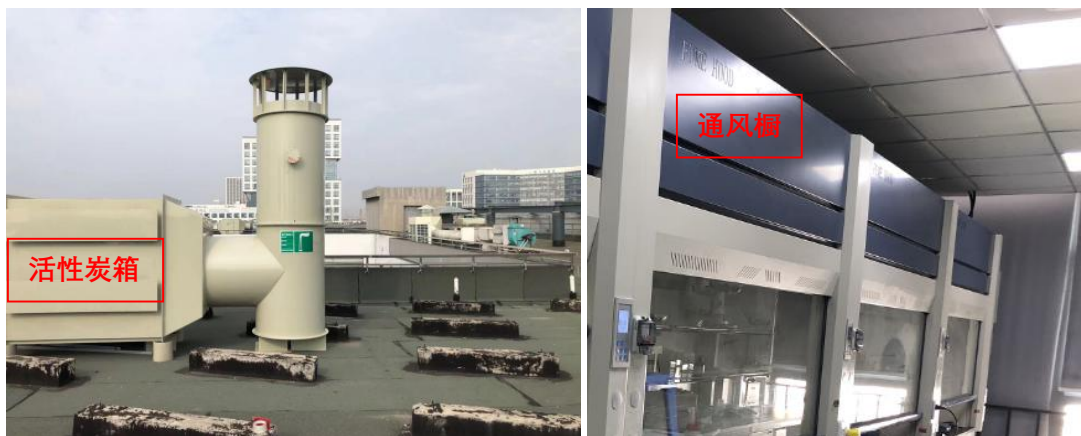
图 7-1 废气处理设施
