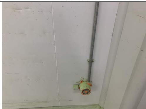
喷涂车间内监测装置
